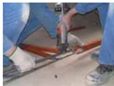
Die Isolierung vor Montage der Rohre ... L'isolation des tuyaux avant leur montage ... Insulation before pipe-laying ...
